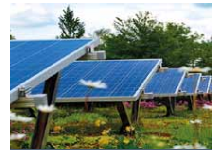
Fotovoltaikdächer mit Begrünung und Retention
